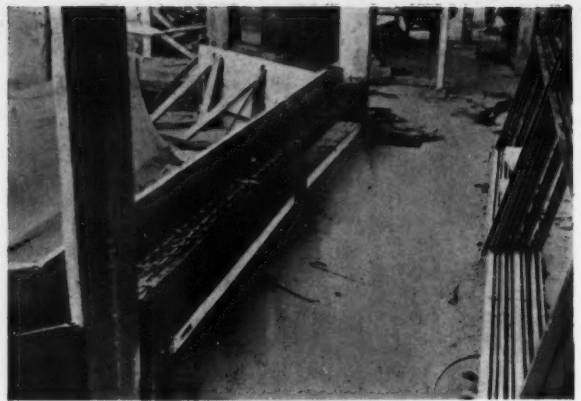
LES CIRCALORS DANS LES ALLÈGES. LE RENVOI DE CHALEUR CALORIFUGÉ PAR DES PLAQUES DE LIÈGE, FORME COFFRAGE
