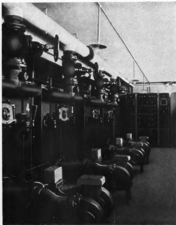
LA CHAUFFERIE ET LE TABLEAU DE RÉGULATION AUTOMATIQUE S. P. C. - MOREAU
