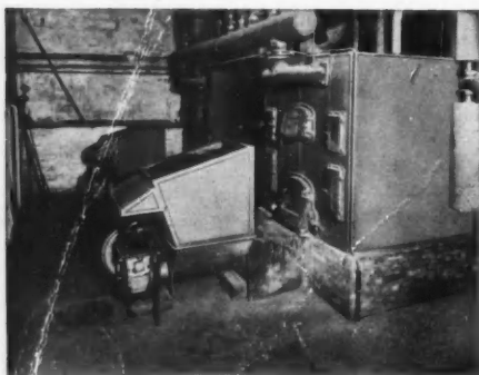
ÉQUIPEMENT DE CHAUFFERIE
