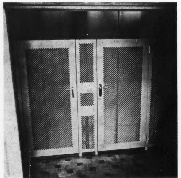
Fig. 12. — PROTECTION ET PORTES PALIÈRES EN TOLE PERFORÉE SUR BATI BOIS (J. GINSBERG, ARCHITECTE)
