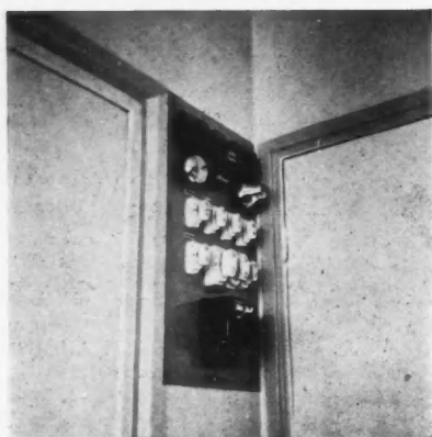
FIG. 18: TABLEAU DE CONTROLE D'APPARTEMENT (sonneries, coupe-circuits à fusibles calibrés, disjoncteur).
