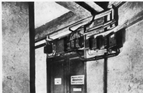
FIG. 4: DISTRIBUTEUR D'ÉTAGE ET FUSIBLES: TYPE D'INSTALLATION PÉRIMÉE
