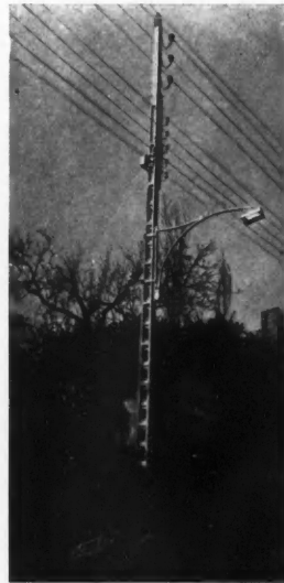
(Omnium d'Installat. électriques) Fig. 25. — Sur poteau béton d'un réseau existant.
