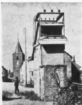
1 POSTE DE TRANSFORMATION EN MAÇONNERIE
