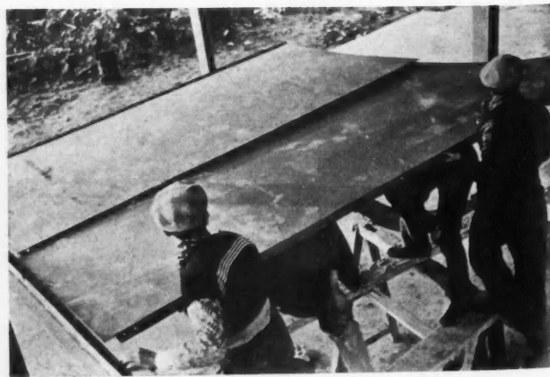
Pose d'éléments de plancher en tôle à l'étage devant recevoir le tapis de caoutchouc.
