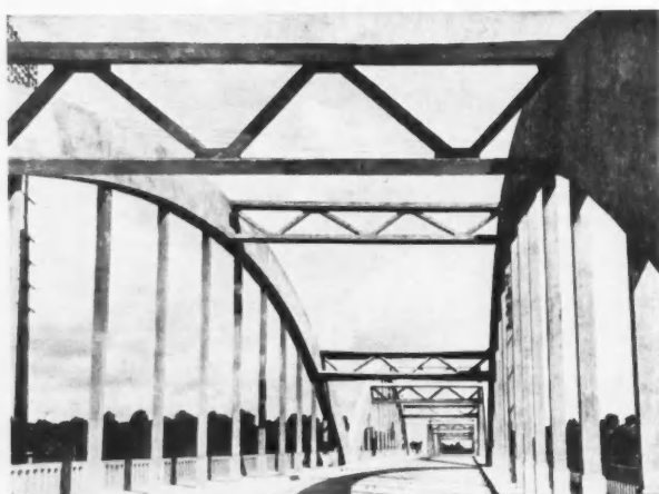
PASSAGE SUPERIEUR EN GARE D'ACHÈRES Contreventement des arcs en poutres à treillis.
