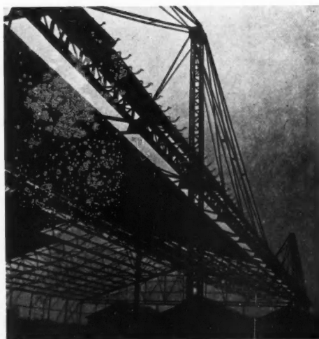
HANGAR POUR AVIONS A TOUSSUS, EN COURS DE MONTAGE (type de couverture suspendue) MARCEL BLOT, ARCHITECTE
