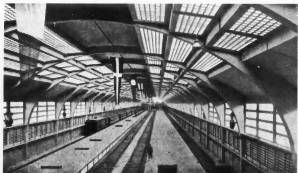
VUE INTÉRIEURE. On aperçoit le joint de dilatation longitudinal à la clef, et, au premier plan, un des joints transversaux.
