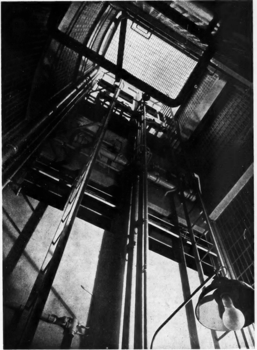
VUE DE LA COURETTE DES CANALISATIONS
