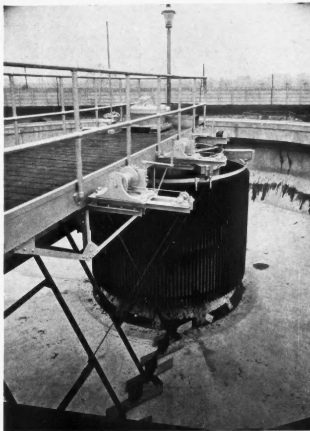
VUE INTÉRIEURE DU SYSTÈME DE RACLAGE D'UN CLARIFICATEUR A PONT TOURNANT ÉTABLI A LA STATION DE COLOMBES (Ville de Paris)
