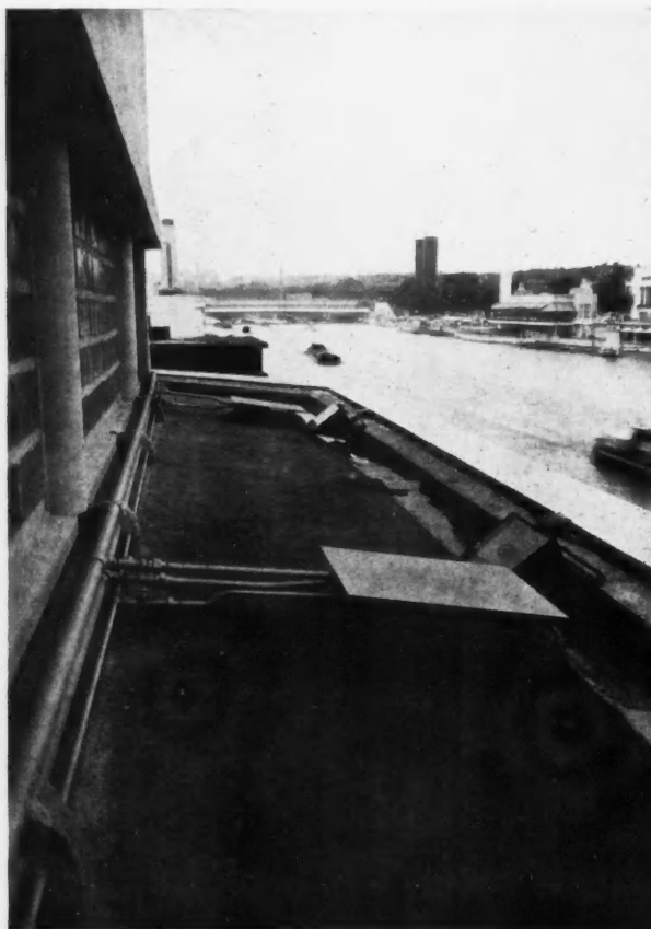
TUYAUTERIE D'ALIMENTATION AU GAZ. VEILLEUSE DES ÉLÉMENTS RADIANTS COX. VUE PRISE SUR LA TERRASSE DU RESTAURANT (par dessus)
