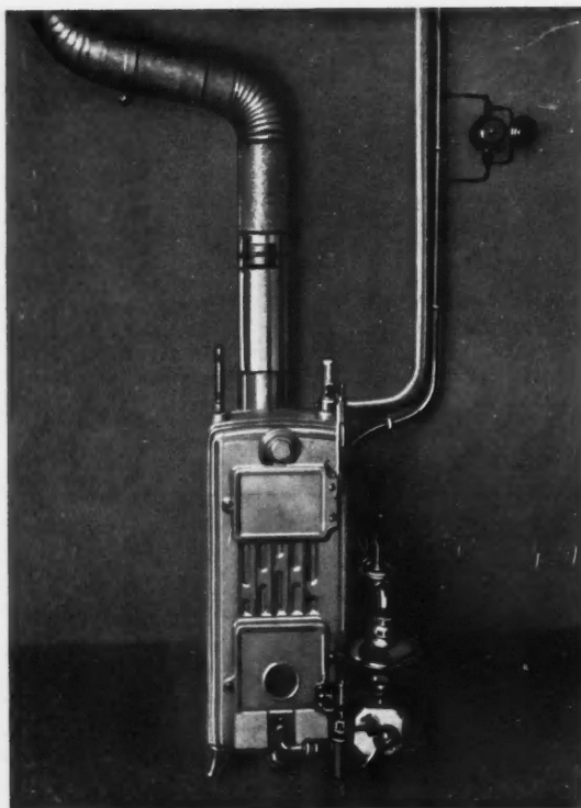
Chaudière transformée pour le gaz (L'Équipement à côté de la chaudière)
