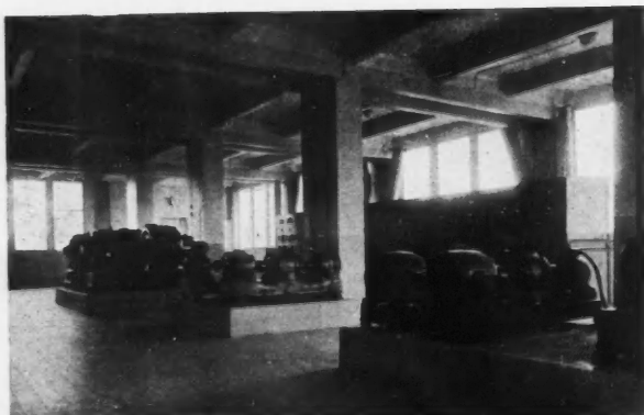
SALLE DES MACHINES
