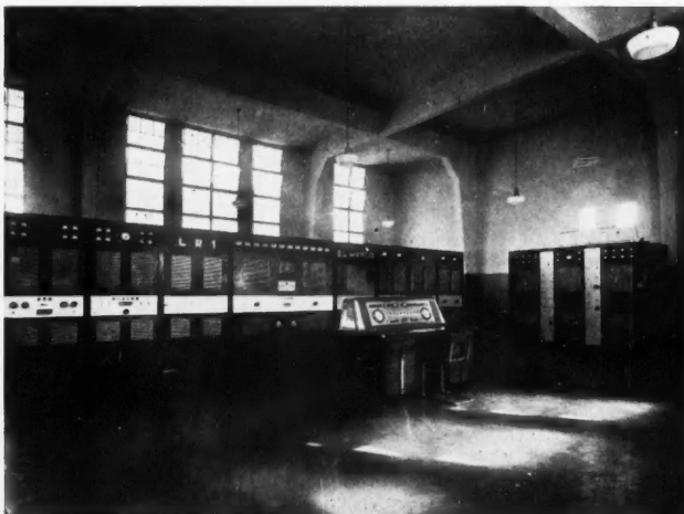
Poste émetteur : Salle de transmission
