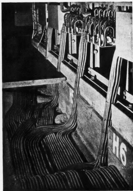
CABINE DE CONTROLE : CABLES RELIANT LES AMPLIFICATEURS AUX STUDIOS ET GAINÉ VERTICALE DISSIMULÉE DANS LE DOUBLE PLANCHER
