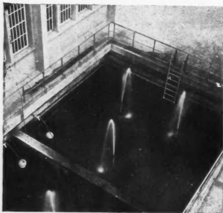
A droite, intérieur de la salle d'émission. Ci-dessous, le bassin de refroidissement.
