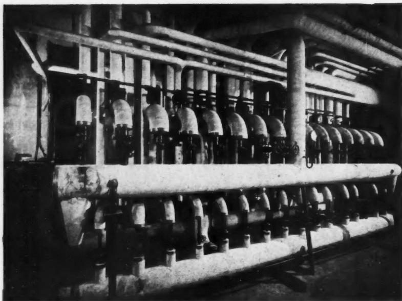
VUE D'ENSEMBLE DES VANNES DE RÉGULATION
