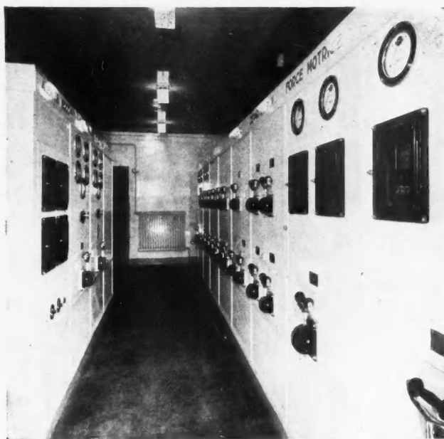
SALLE DU TABLEAU GÉNÉRAL DE DISTRIBUTION
