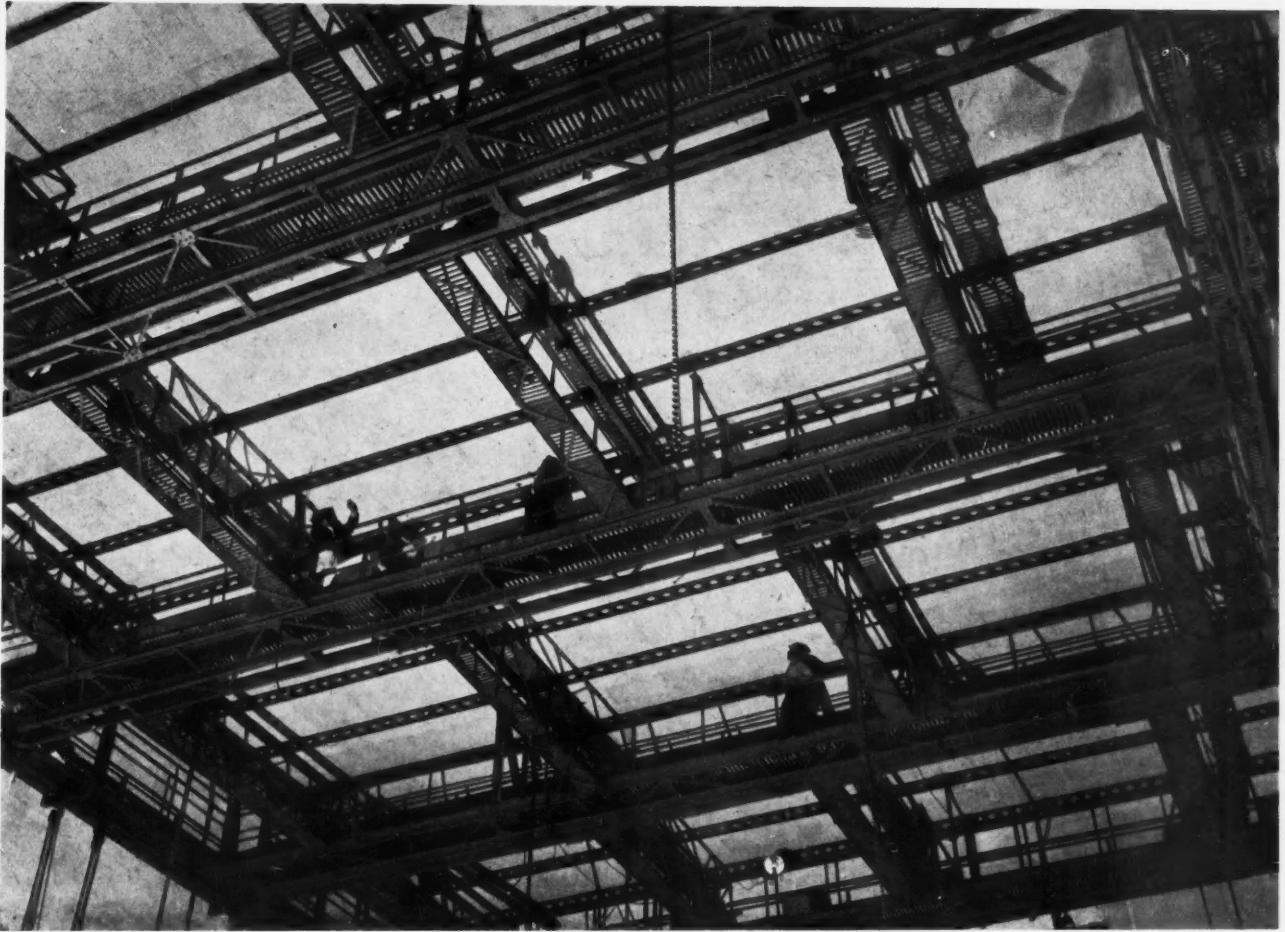
« PARIS - STUDIOS-CINEMA » A BOULOGNE-BILLANCOURT. Vue du plafond du Studio A, avec les seize ponts roulants.
