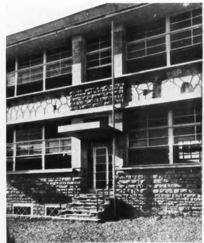
DÉTAIL DE FAÇADE DES CLASSES: MOELLONS DE PREMEAUX ET DALLES DE COMBLANCHIEN
