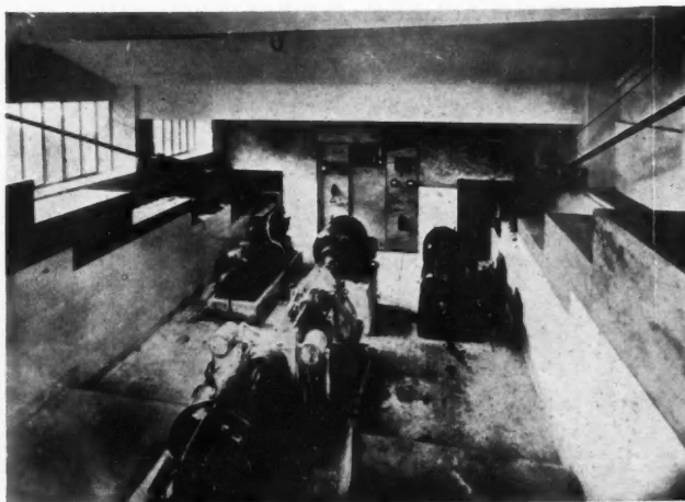
INTÉRIEUR DE LA STATION INFÉRIEURE (STATION MOTRICE)
