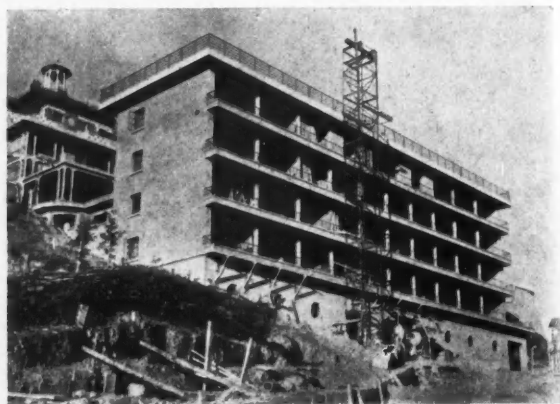
Un bâtiment du Sanatorium des Etudiants à St-Hilaire du Touvet. Architecte : M. Sage, D. P. L. G., à Vanves.
