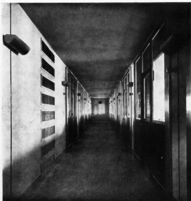
UN COULOIR DE BUREAUX, BOUCHES DE SOUFLAGE ET DE REPRSE D'AIR
