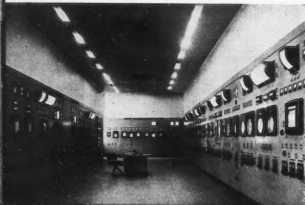
Salle de contrôle et de commande.
