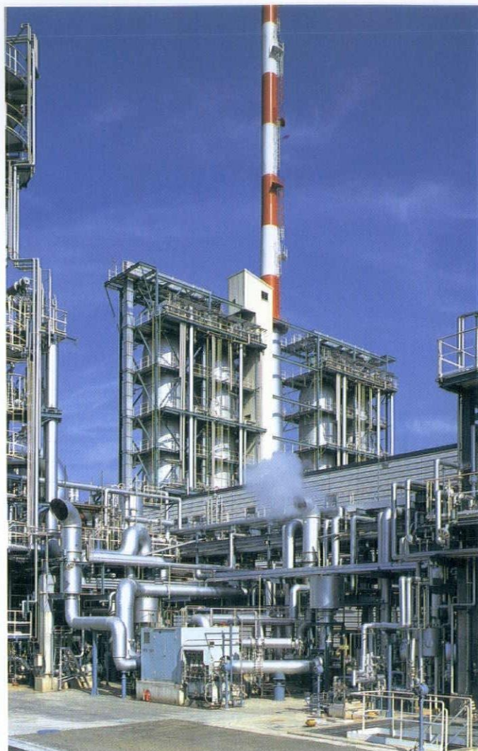
残油脱硫装置
