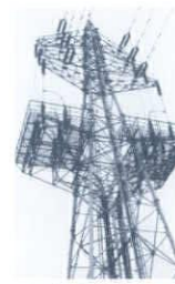
16: 送電線鉄塔 1: 習志野市芝園3 3: 高さ40m
