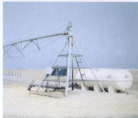
(株)フジタの海水灌漑システムの散水装置ピボットの中心部分
