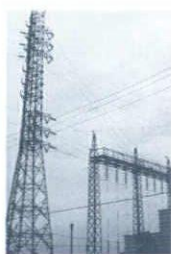
1: 東京電力茜浜変電所送電塔 1: 習志野市茜浜2 2: 東京電力 3: 高さ50m
