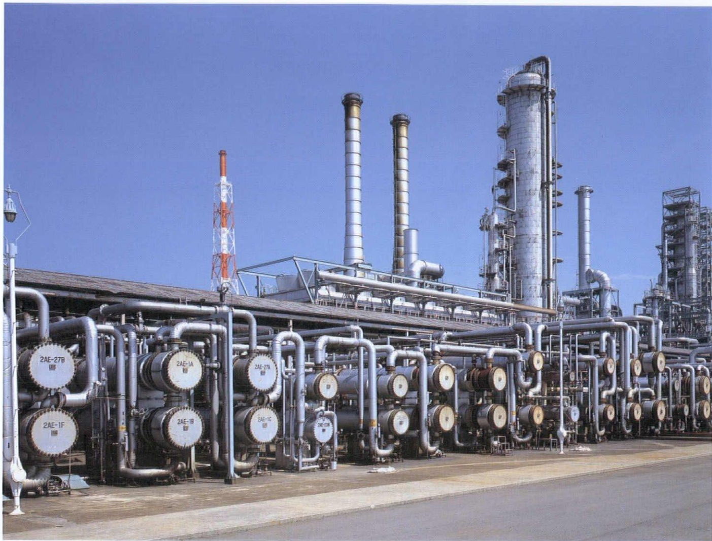
常圧蒸留装置
