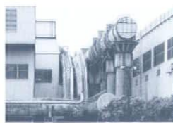
3: 川崎製鉄今井門ダクト 1: 千葉市中央区川崎町 2: 川崎製鉄 3: 高さ15m
