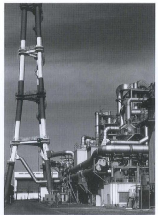
煙突と汚泥焼却炉
