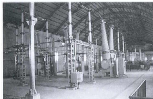
黒部第四発電所変電所開閉所
