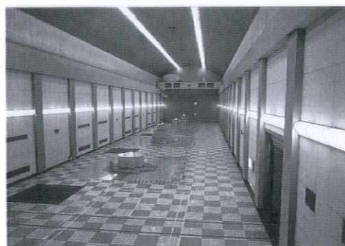
黒部第四発電所発電機室
