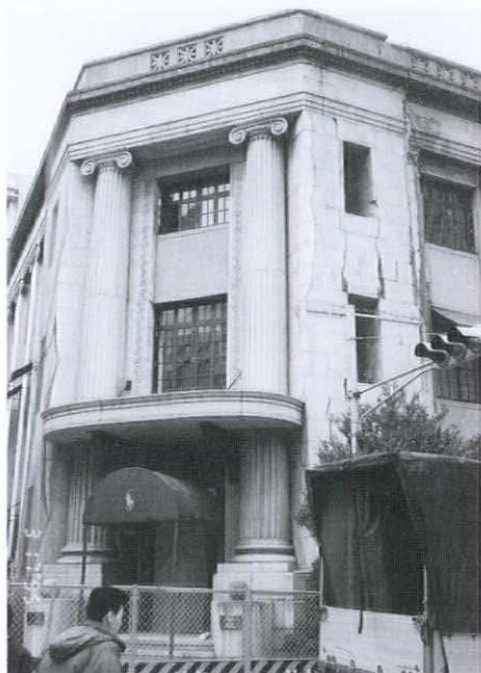
損傷を受けた旧内田汽船ビル
