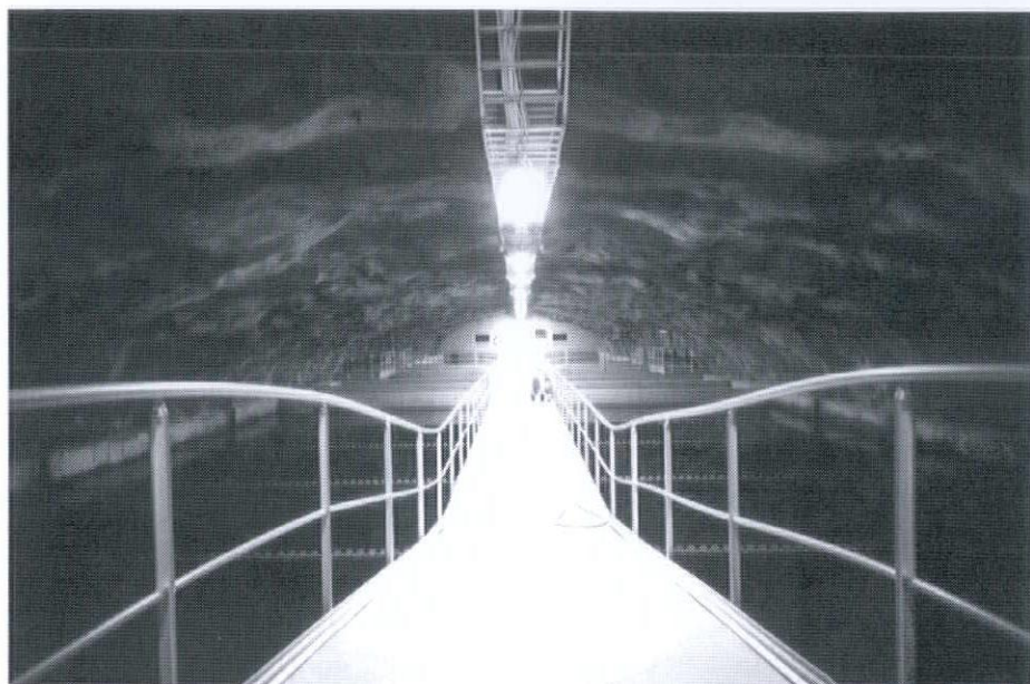
ヴィーキンマキ下水処理場の汚水沈殿槽
