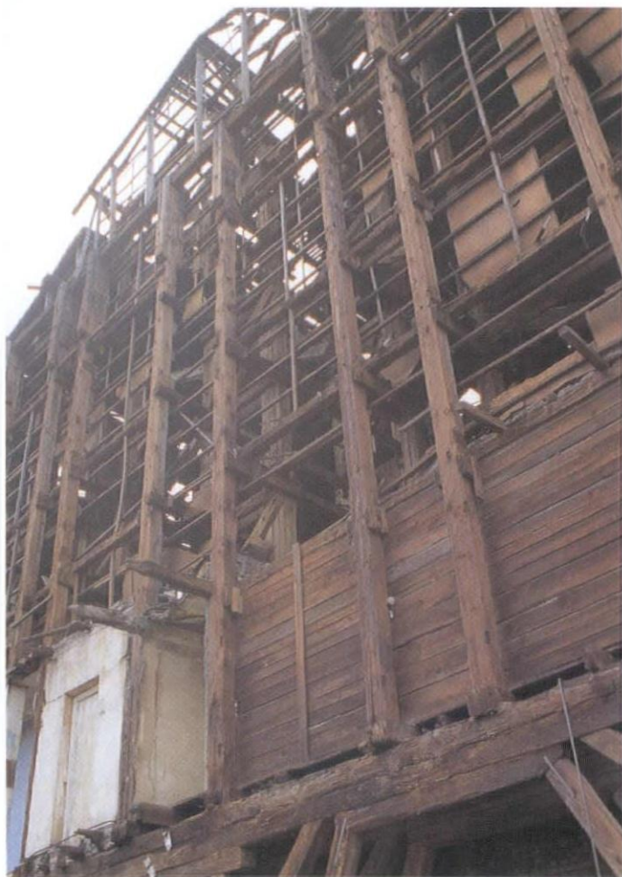
図-3 〈ルーバンの化学工場〉高さ20mほどのこの建築は木造であった
