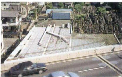
天井からの給油設備のための配管
