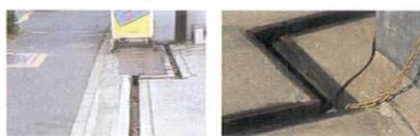
漏れた危険物の空地外流出防止のための排水溝
