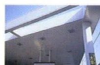
パネル仕上げに埋込みの 照明器具
