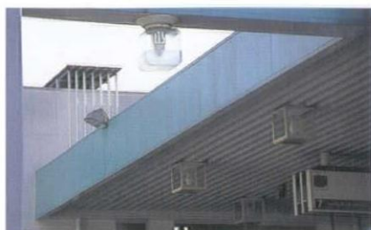
地下タンクから天井まで油を運ぶ配管の列
