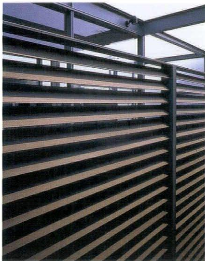
2階テラスの南側に設けられた可動ルーバー。 ハンドルの回転操作で角度を変えられる
