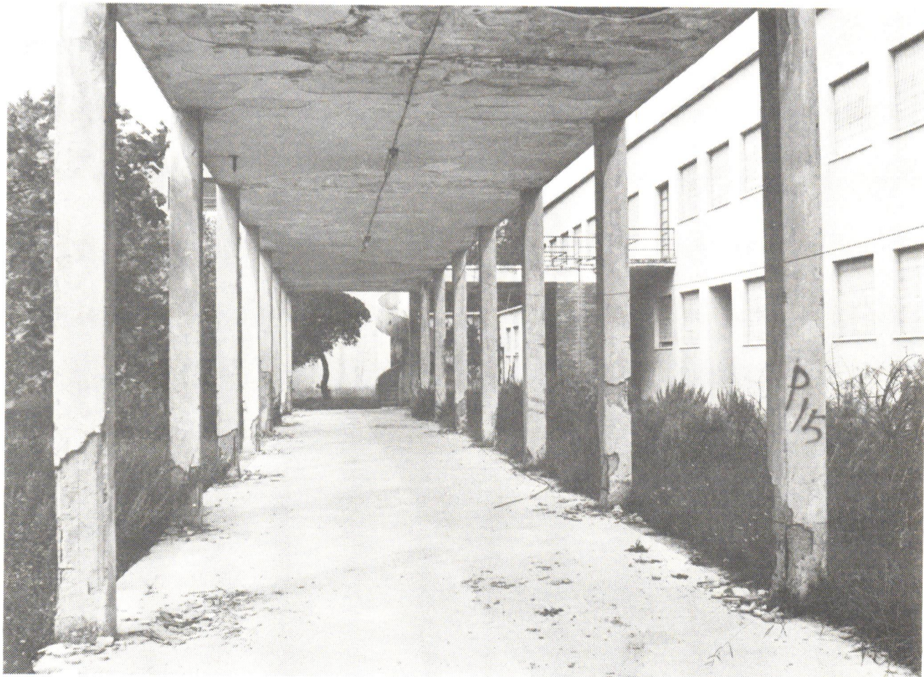
Figure 6 Ettore Sottsass and Alfi Guitoli, Sea Colony, Marina di Massa, 1937. Photo by Diane Ghirardo.
